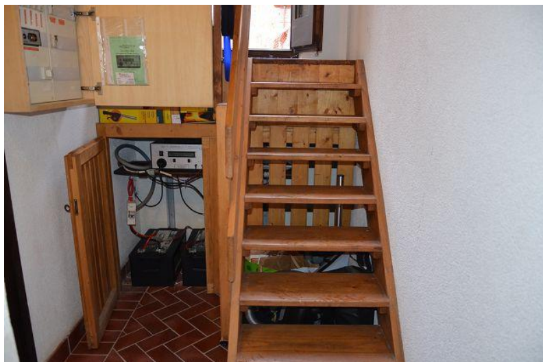
Fotovoltaik Anlage / impianto fotovoltaico
