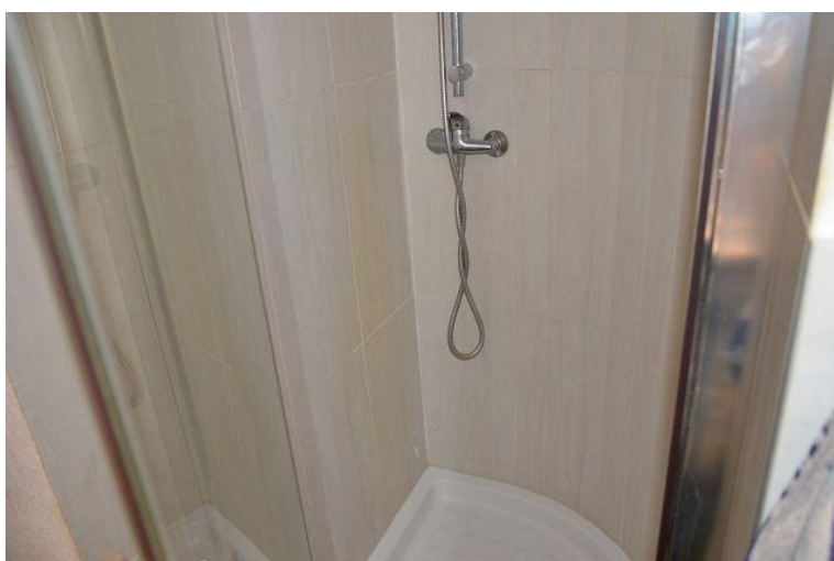
Dusche Haus West / doccia casa ovest
