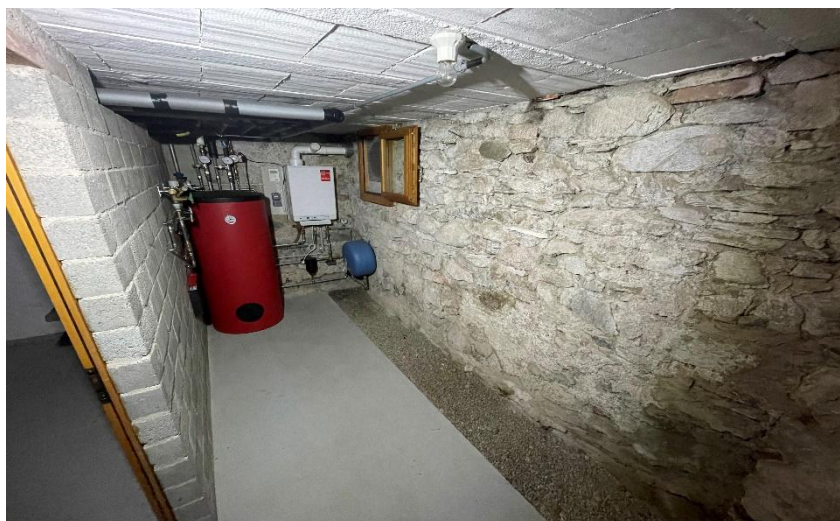
Gasheizung mit Heizschlangen / Riscaldamento a gas con serpentine
